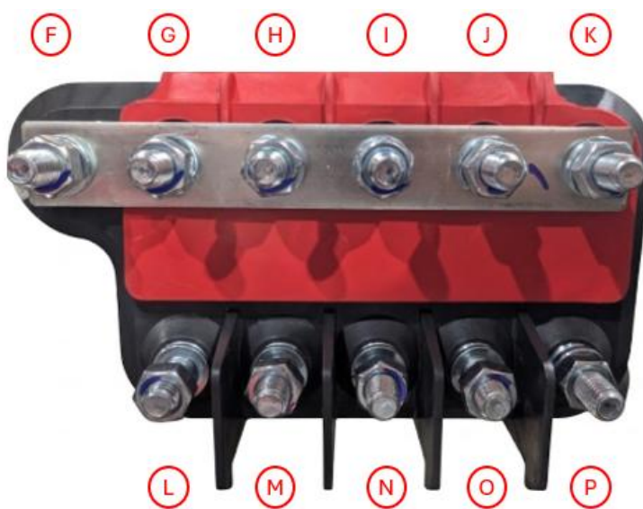
Figure 18 : Boîte à fusible 48V
