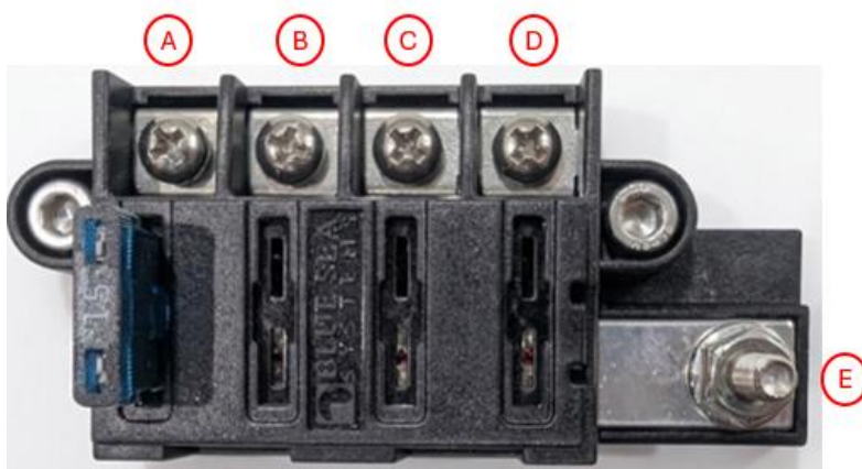
Figure 17 : Boîte à fusible 12V
